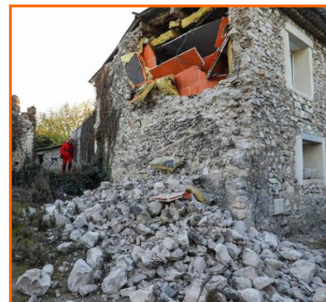
Habitation endommagée lors du séisme du Teil le 11 Novembre 2019
